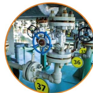
Stacja uzdatniania wody
